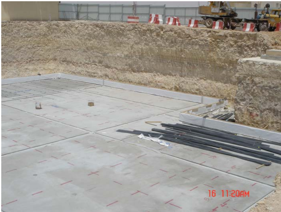
Védőlemez kilátszó fugaszalagokkal
